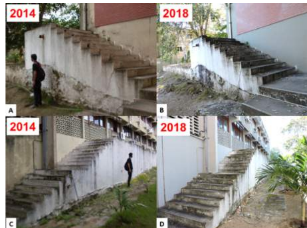
Figura 5. (A) Escadaria alta e sem proteção lateral fotografada em 2014; (B) Mesma escadaria do quadrante (A) fotografada em 2018; (C) Escadaria e calçada altas e sem proteção lateral fotografada em 2014; (D) Mesma escadaria e calçada altas do quadrante (C) fotografada em 2018. Fonte: Fotos: Lázaro Avelino, 2014/18.
